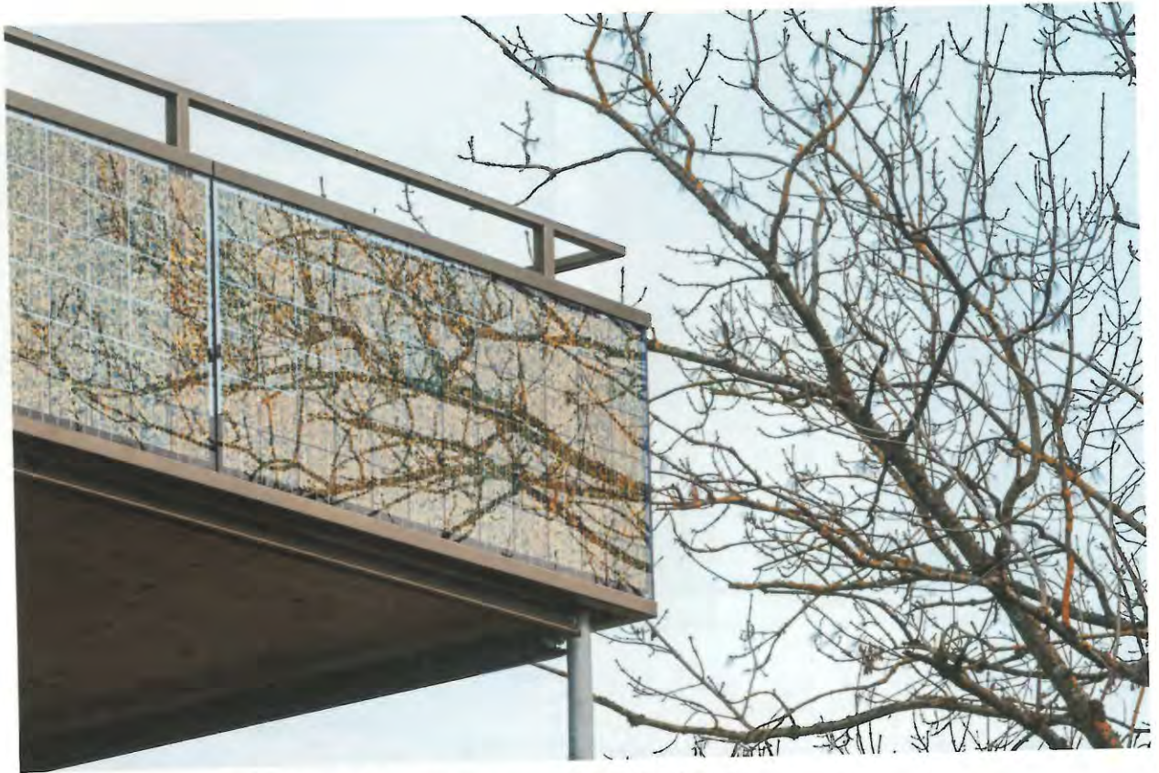
Die polykristallinen Photovoltaikzellen an der Balkonbrüstung passen sich in die Umgebung ein.
