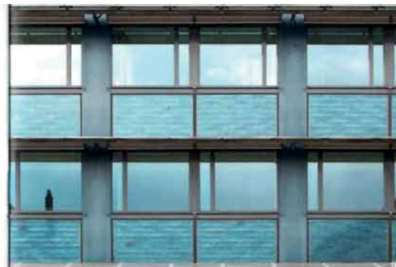
1a | 1b Wohn- und Gewerbehaus an der Limmattalstrasse in Zürich: 52 Quadratmeter Sonnenkollektoren unterstützen die Holzheizung. Die PV-Vordächer beschatten die Fenster und sind gleichzeitig sommerlicher Wärmeschutz und lassen im Winter die Sonne tief ins Gebäude scheinen.
